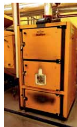
Kotłownia na Pellet ZS3
